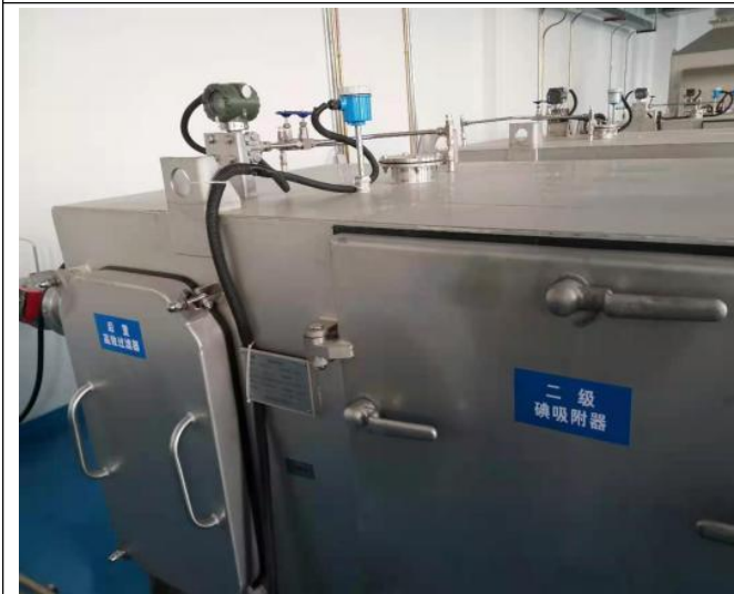
废气过滤设施
